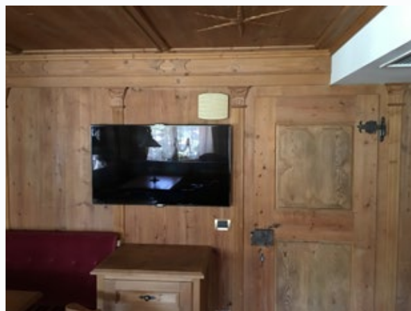
Installazione Access Point TP-LINK
