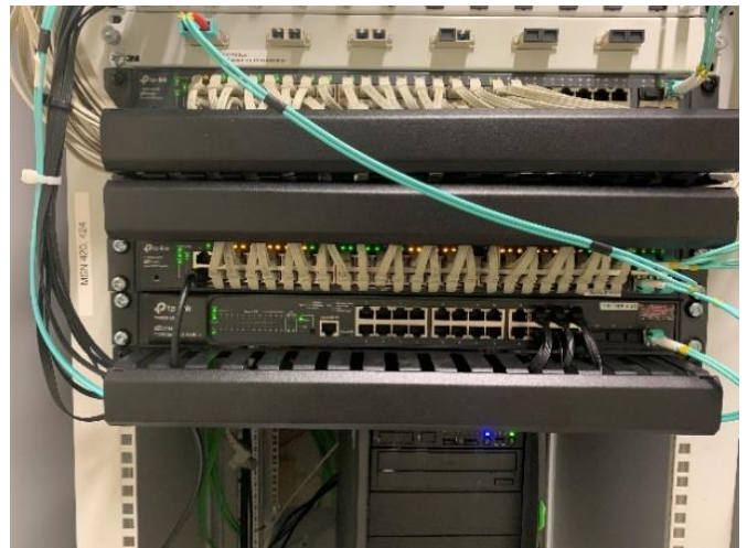
PoE Switch beliefert die EAPs mit Strom und Datenzugang
