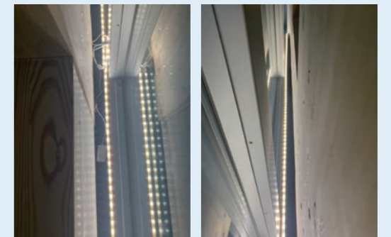
現場の設置イメージ
